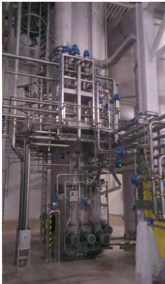
Rys. 9. Wyparka stosowana w zakładzie.
