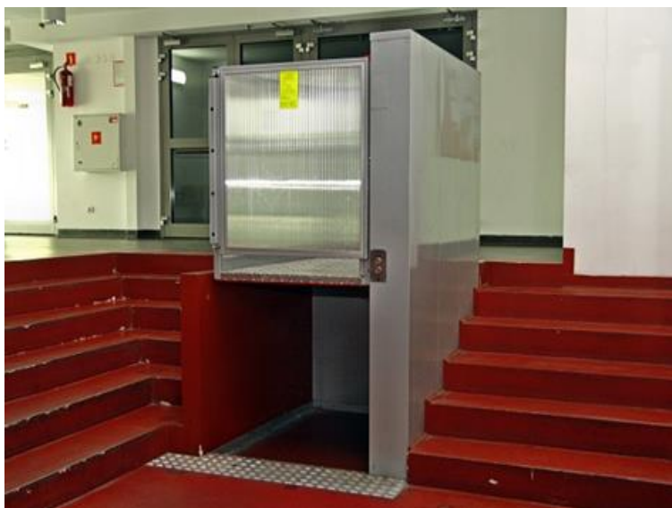
Fotografia 11. Winda dla osób z niepełnosprawnościami Źródło: dokumentacja wewnętrzna MANS
